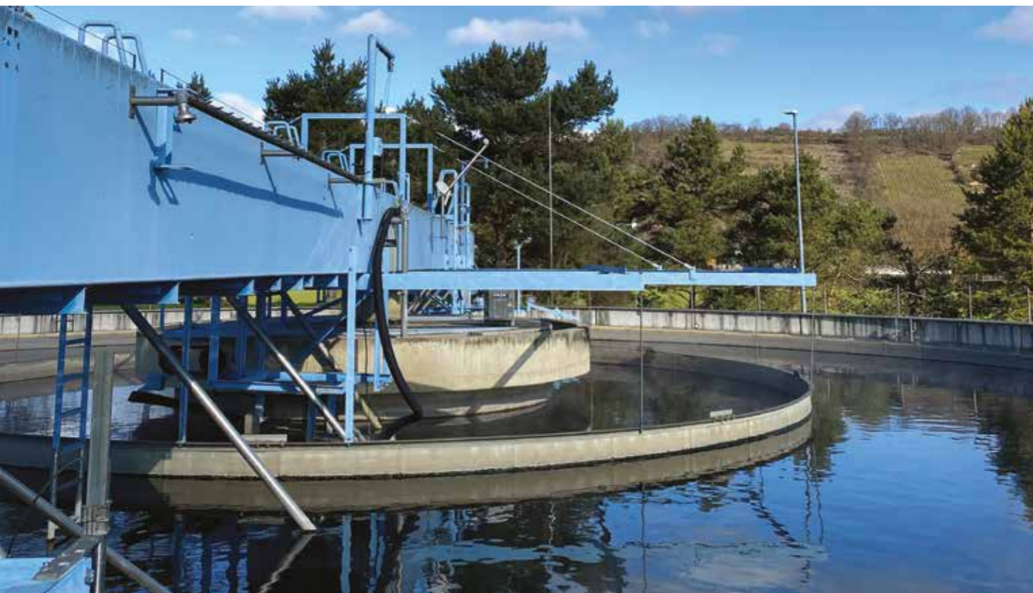
Kläranlage der Papierfabrik Palm in Eltmann.
