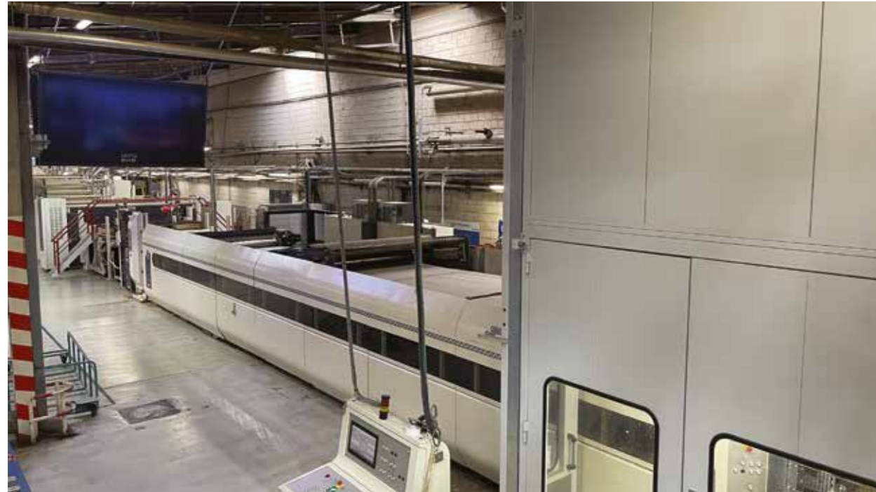
Die neu installierte Wellpappenanlage bei Seyfert Forez.
